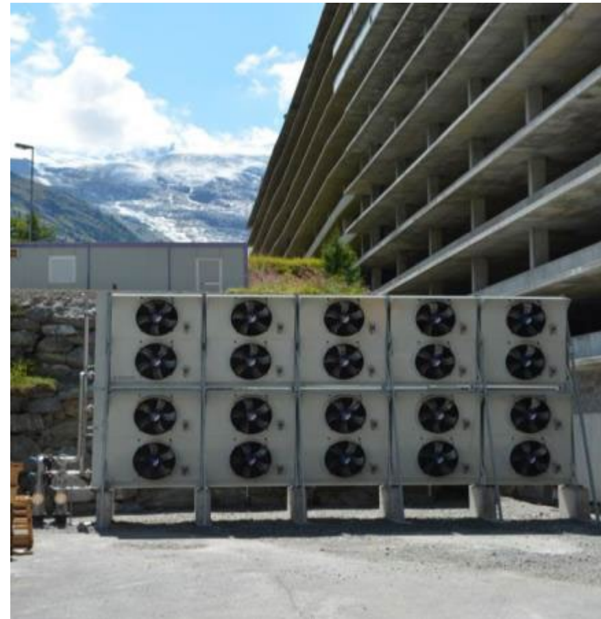
Ausseneinheit Wärmepumpe 20 Lüfter
