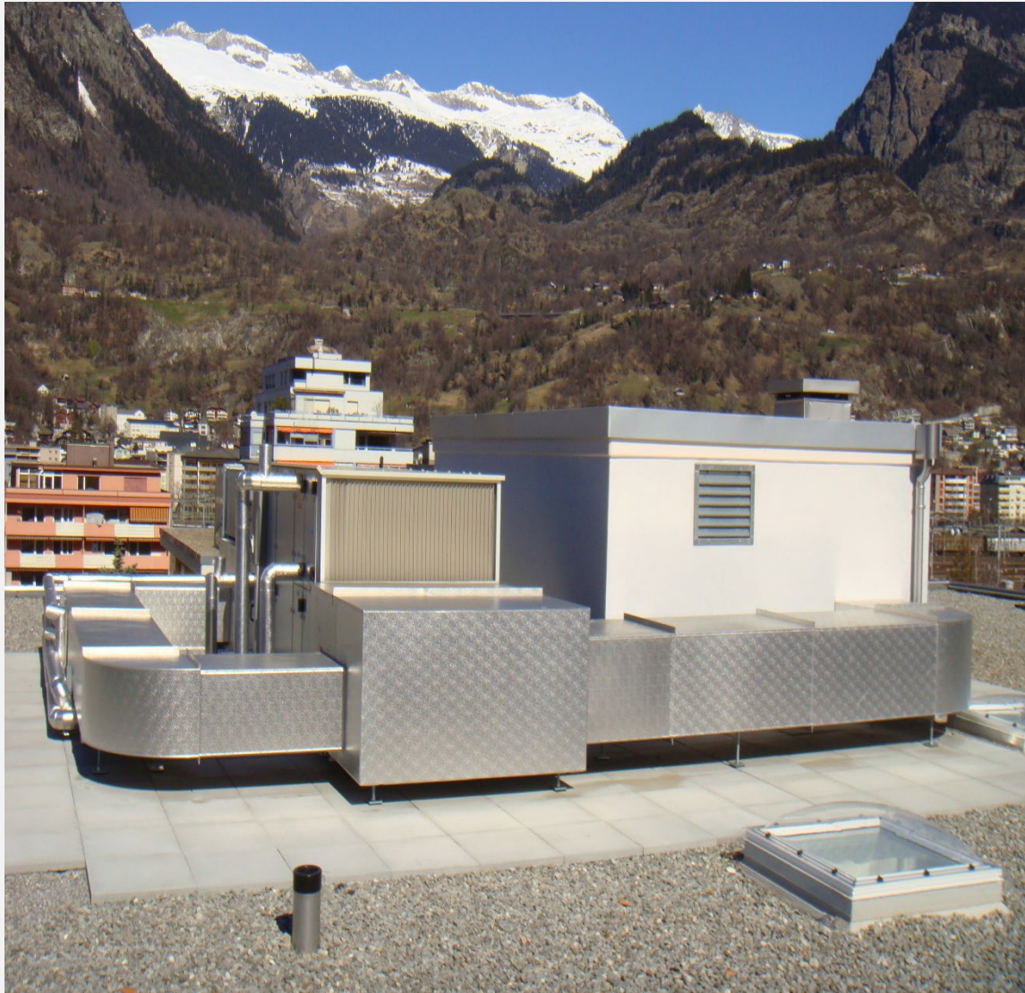
Lüftungsgerät auf dem Flachdach
