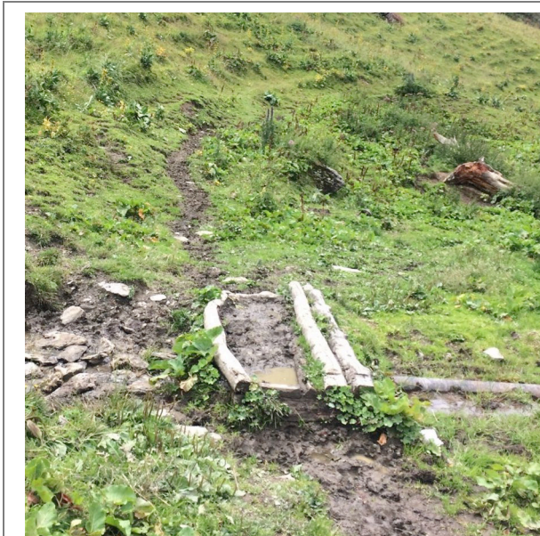
Trittschäden in feuchtem Weidegebiet und Schäden an der Brücke (Quelle: BikePlan AG)
