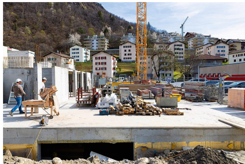
Der Schritt vom Dorf zur Stadt geschieht hier innert Monaten statt über Jahrzehnte: Baustelle in Visp.
